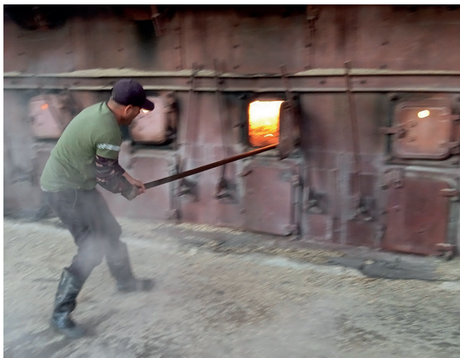
El correcto funcionamiento de las calderas garantiza la generación de vapor imprescindible para el proceso fabril. / Fotos: del autor
