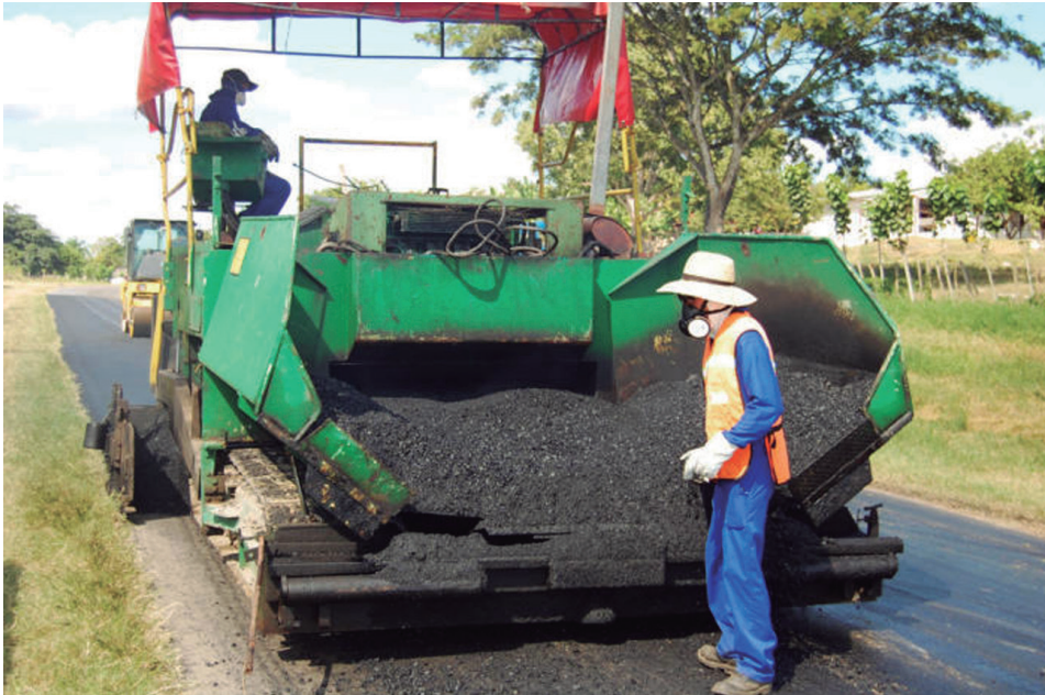
La pavimentación es una de las labores más importantes que ejecutan los trabajadores de esa entidad. / Fotos: del autor
