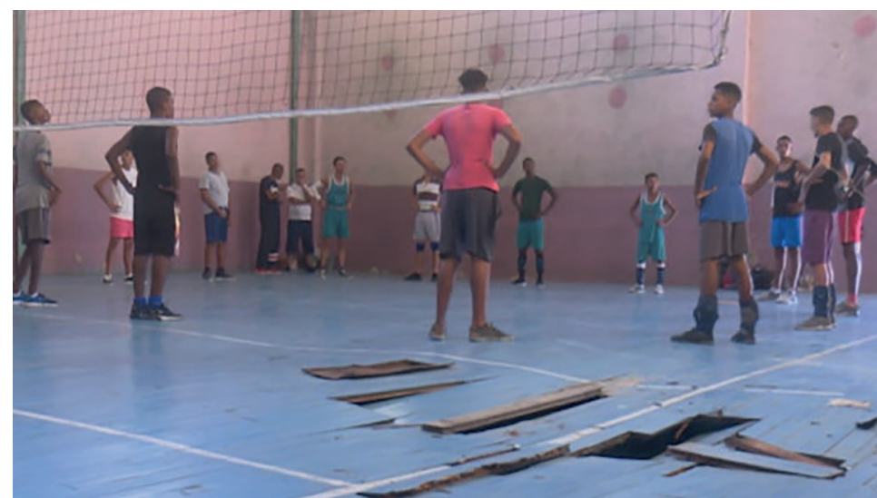
Varias instalaciones deportivas requieren una urgente reparación. / Fotos: del autor
