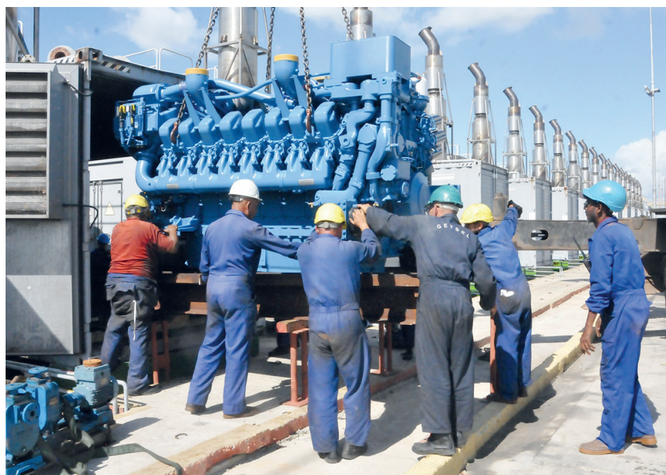
Ya están en el emplazamiento doce de los 20 motores remanufacturados que deben quedar montados este año.
